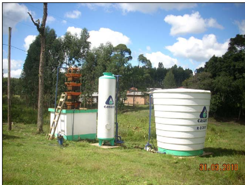
Figura 12 – Vista da ETA do Sistema Rio da Anta
