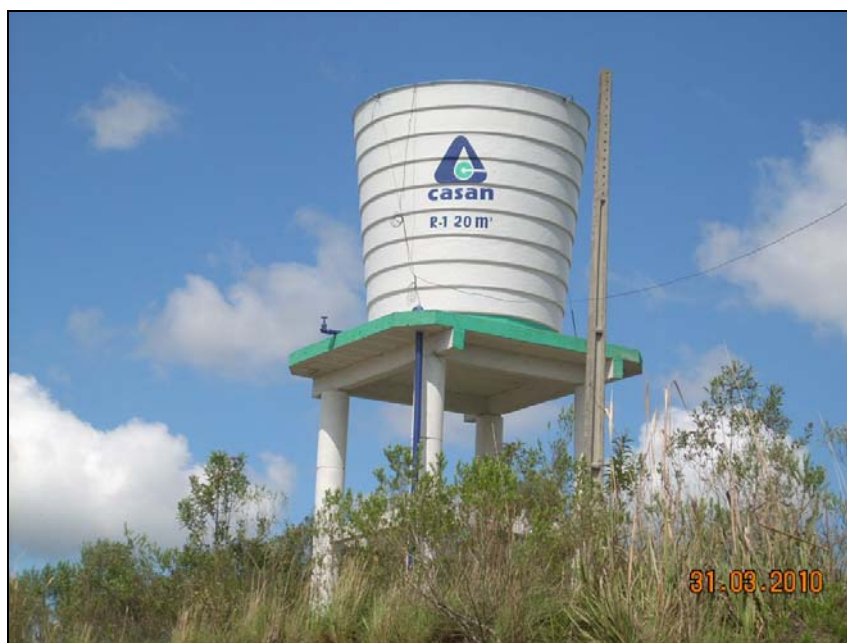
Figura 13– Reservatório R4 - Sistema Rio Anta
