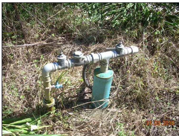
Figura 14 – Poço profundo Sistema Craveiro
