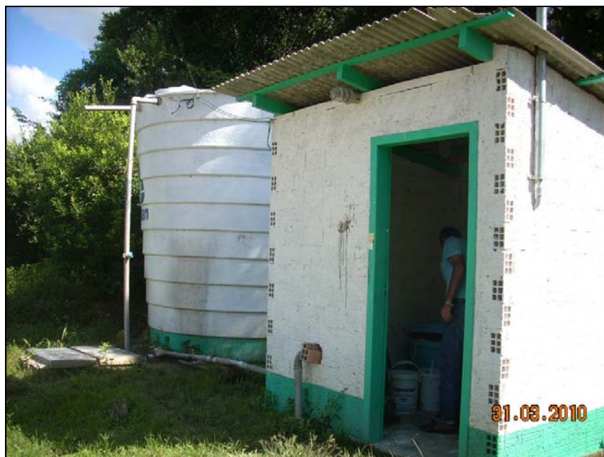
Figura 16 – Vista da ETA do Sistema Craveiro
