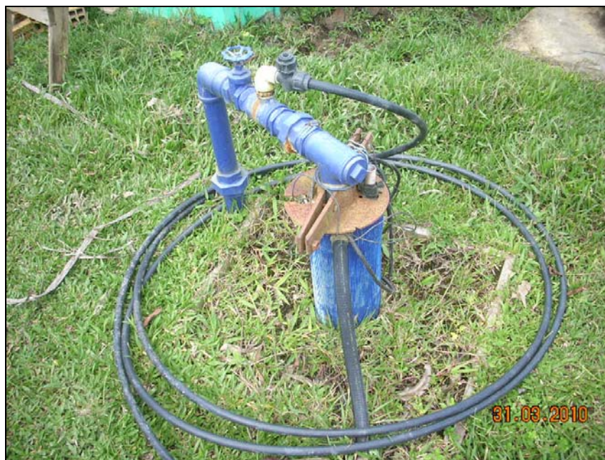
Figura 10 – Captação Sistema Rio da Anta
