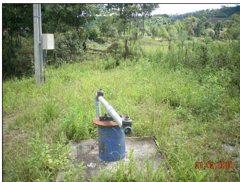
Figura 6 – Captação – Poço Profundo
